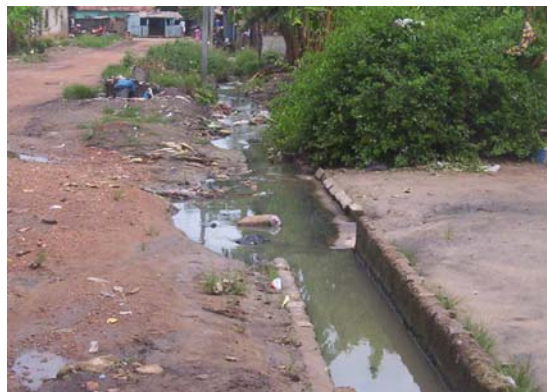
Caniveau à ciel ouvert et obstrué au plein cœur de la ville de Tiassalé
