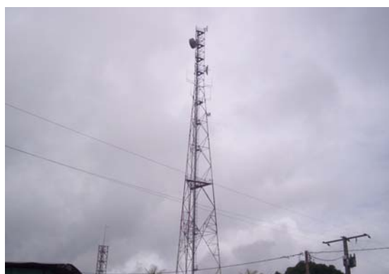
Infrastructures de télécommunication à N'DOUCI
